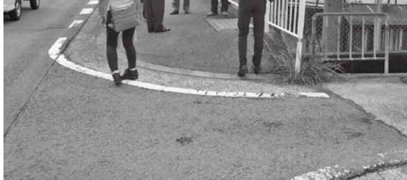
問題となっている国道42号との接合地点
