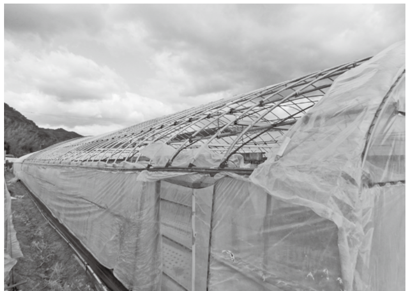
被災したパイプハウス
