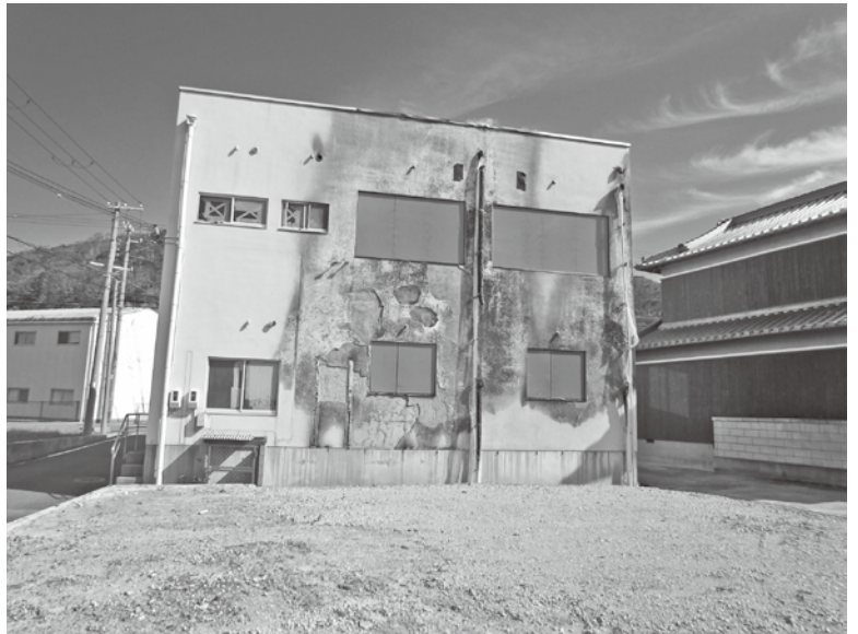
被害を受けた萩原集会所
