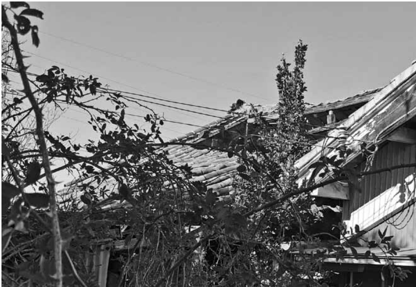
危険な状態になっている空き家
