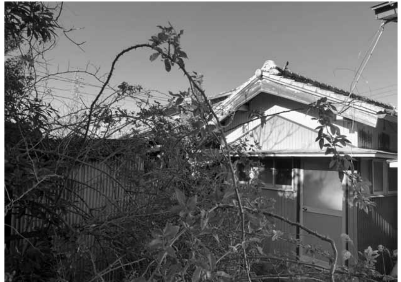
周辺に危険を及ぼす状態の空き家
