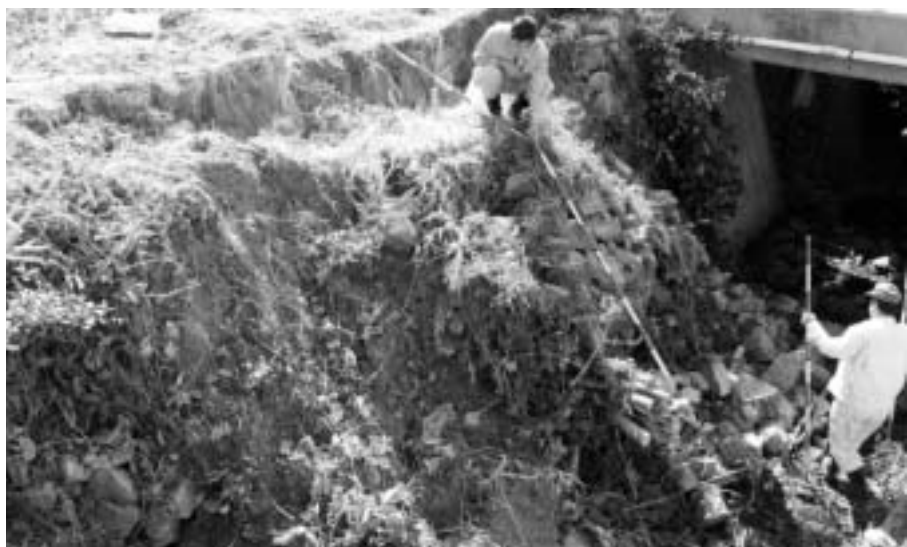
台風による被害（産湯小谷川）
