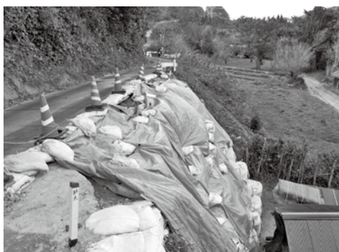
台風12号による被害(津久野)
