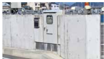
阿尾地区陸閘操作盤
