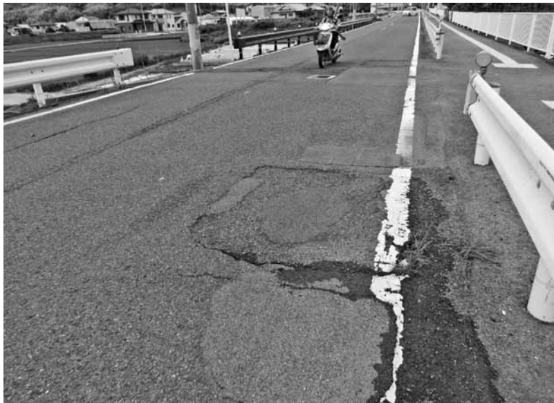
傷みが激しい県道（小中地内）
